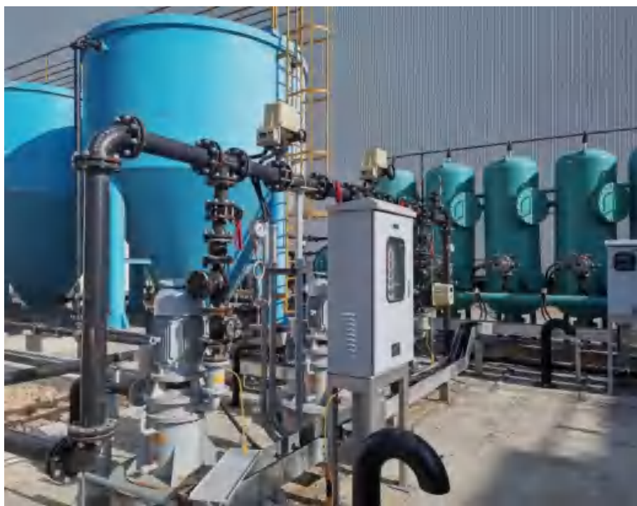
图 8.1.2-4 营运期煤污水处理站
