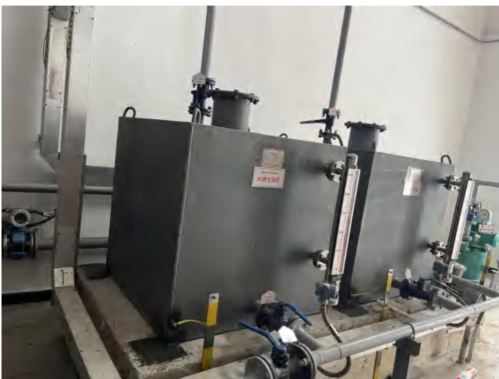
图 8.1.2-2 营运期含油污水处理站（再生油箱）
