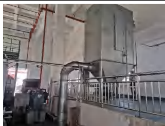
转运站除尘器
