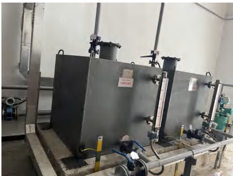
图 5.1-9 营运期含油污水处理站（再生油箱）
