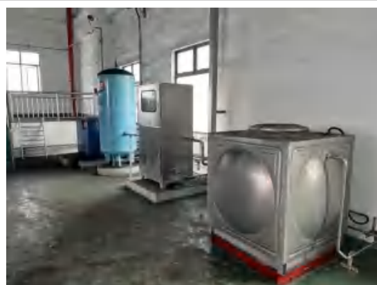
干雾除尘设施
