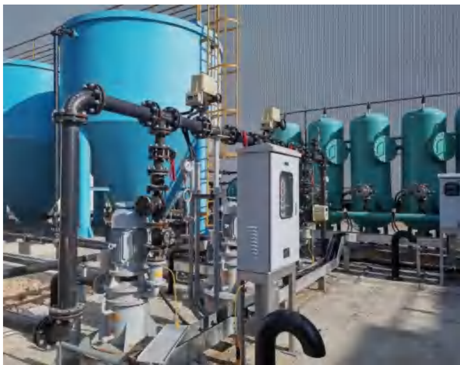
图 5.1-11 营运期煤污水处理站
