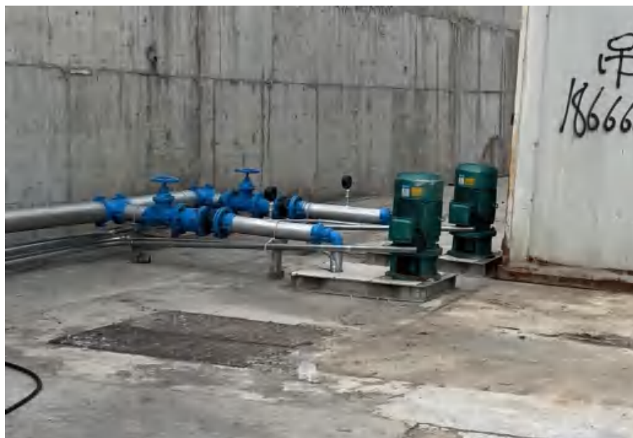
图 5.1-12 营运期码头应急事故池
