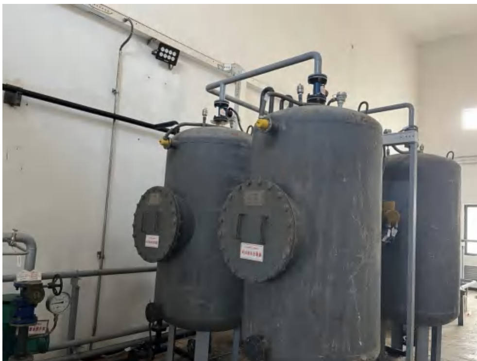
图 5.1-8 营运期含油污水处理站（油水分离器）
