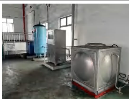
干雾除尘设施
