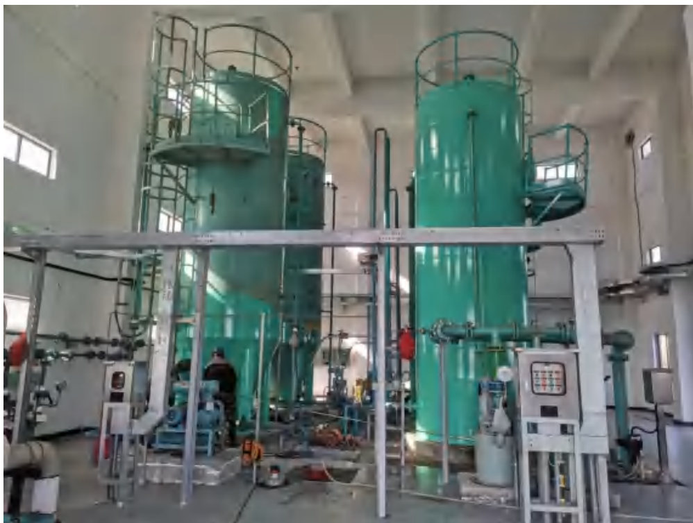
图 5.1-10 营运期生活污水处理站
