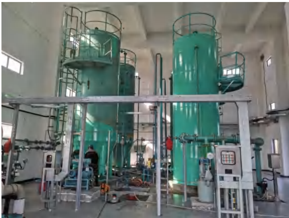
图 8.1.2-3 营运期生活污水处理站
