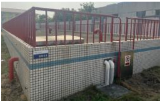
消防水池及泵房
