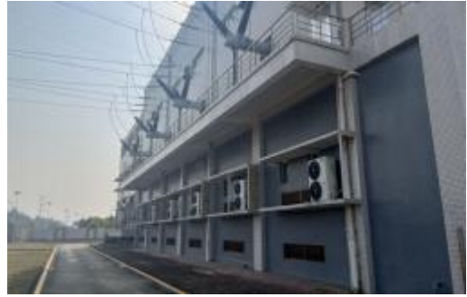
双山站配电装置楼
