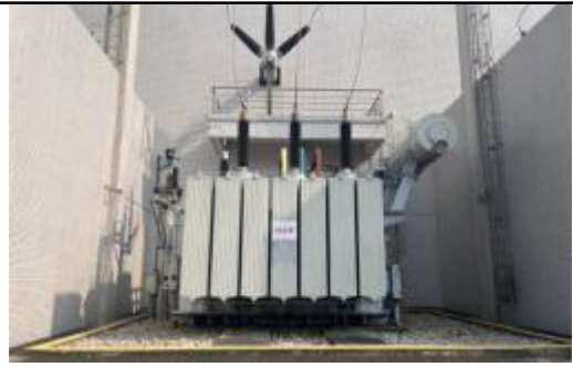
2#主变压器（50MVA）
