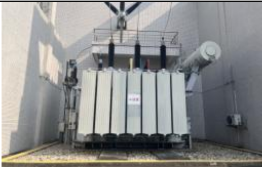
1#主变压器（50MVA）
